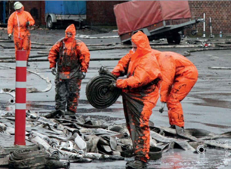
Feuer Nartenstraße HH-Harburg, 2012: The day after – das große Aufräumen
